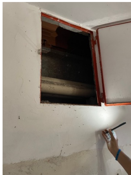
Dettaglio botola ispezione vano impianti piano terra
