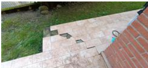
Distacco rivestimento con fessurazioni/cedimenti dei marciapiedi perimetrali esterni.
