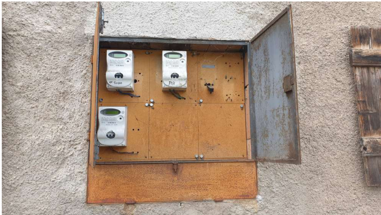
QUADRO CONTATORI CORRENTE ELETTRICA (LATO EST)
