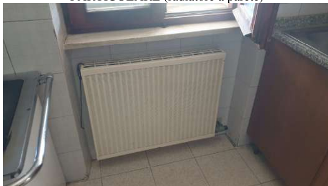
PARTICOLARE (radiator a parete)
