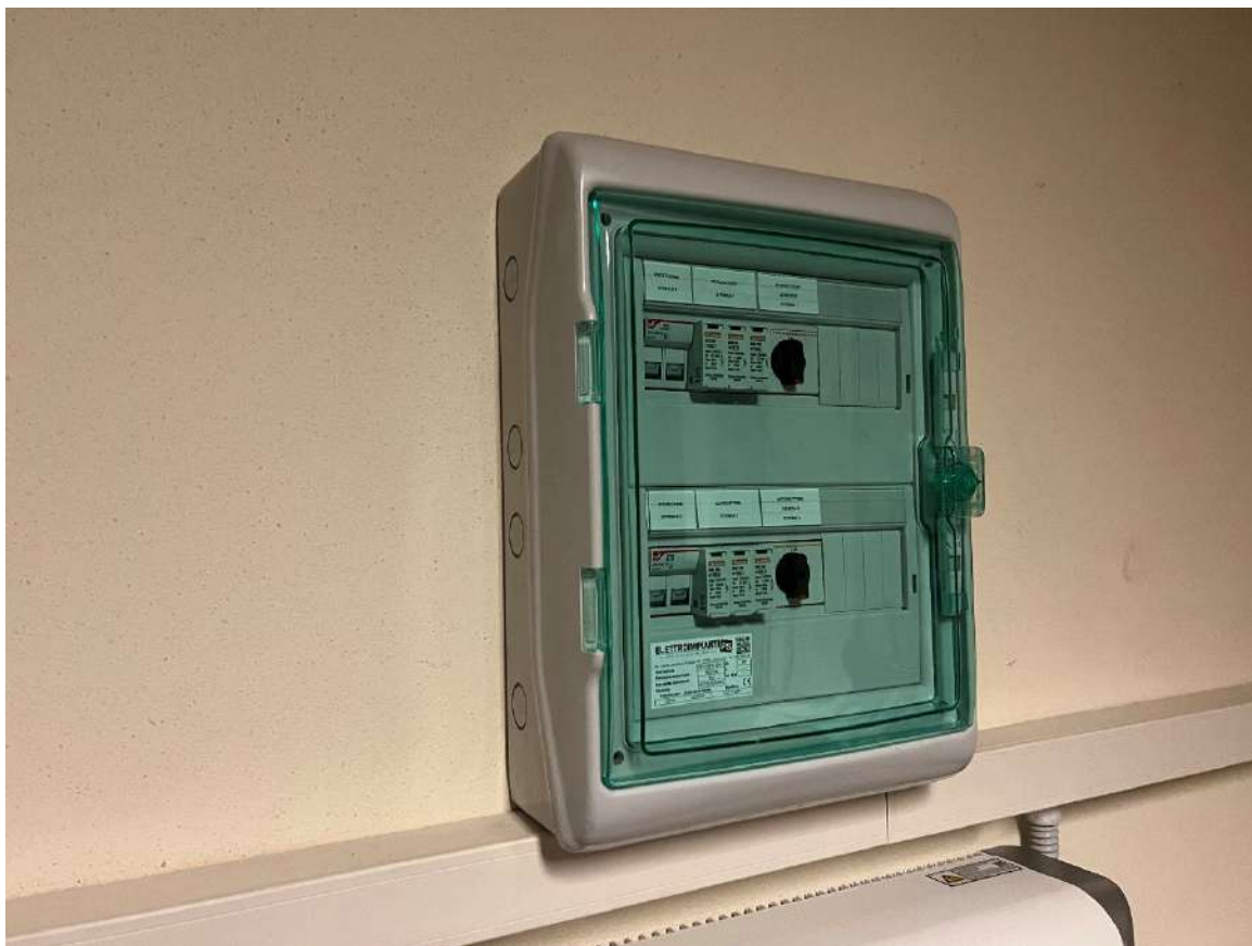
Figura 11 dettaglio imp elettrico
