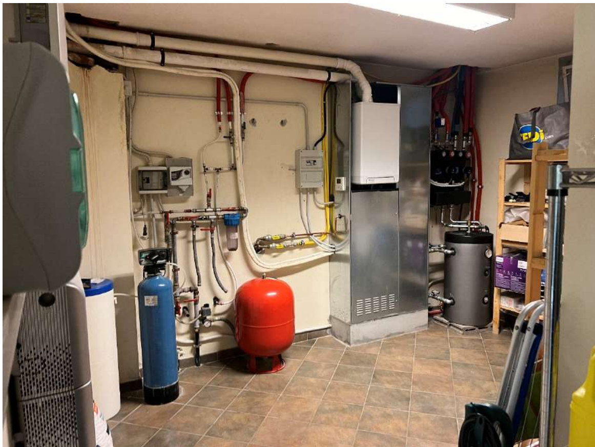
Figura 10 impianti piano interrato
