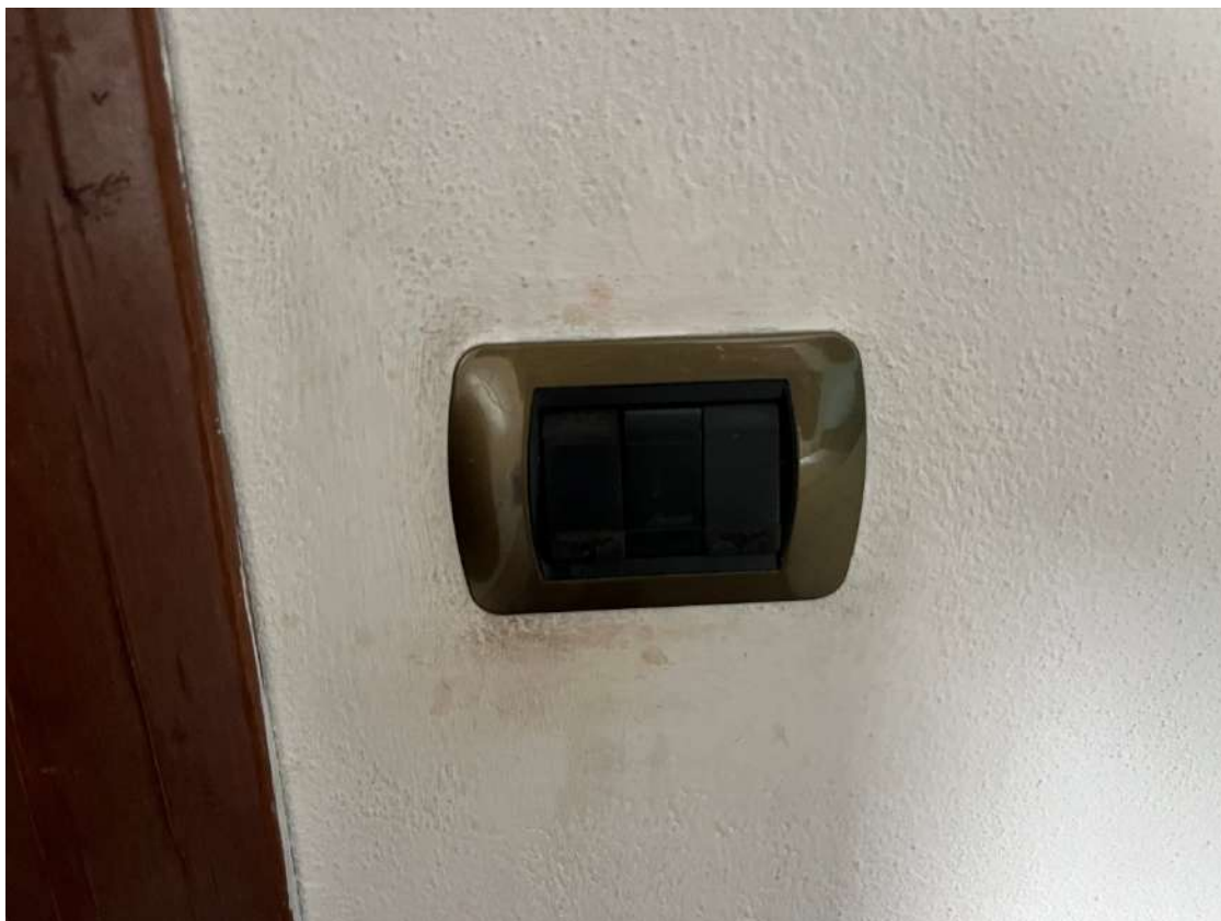
Figura 7 dettaglio impianto elettrico
