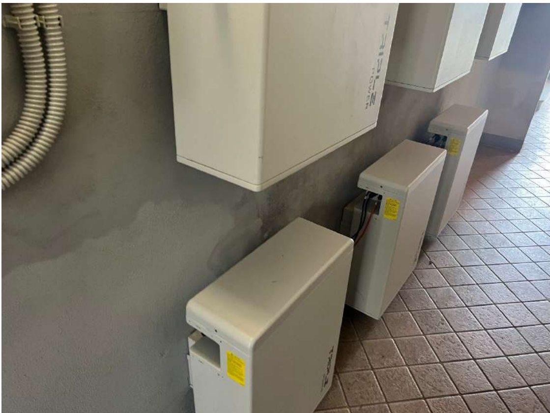
Figura 2 dettaglio imp. fotovoltaico condominiale
