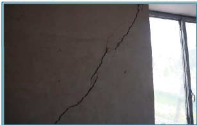
Figura 43 Particolare della lesione presente internamente
