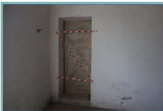
Interdizione dei locali al piano primo (subalterno 4)
