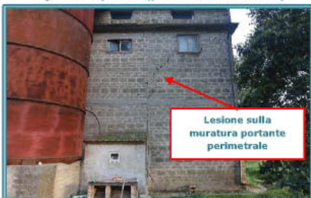
Figura 39 Facciata lato ovest con in evidenza la lesione
