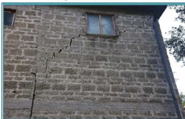
Figura 40 Particolare con in evidenza la lesione
