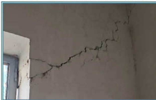
Figura 44 Particolare della lesione presente internamente
