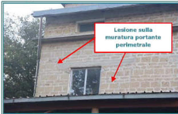
Figura 42 Facciata lato est con in evidenza la lesione
