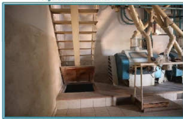
Figura 27 Laminatolo con scala di accesso al piano primo
