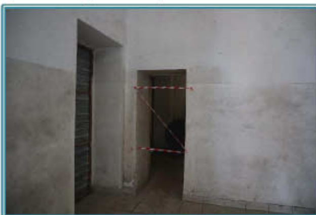
Interdizione dei locali al piano terra (subalterno 4)
