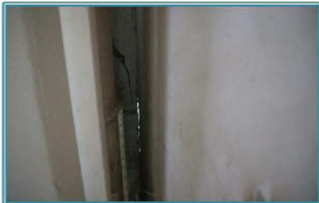
Figura 41 Particolare della lesione presente internamente
