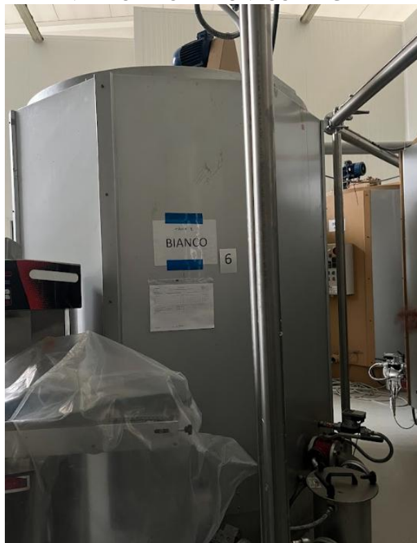
A.8., A.9., A.10. TANK BIANCO CON POMPA VOLUMETRICA, FILTRO, MISURATORE DI LIVELLO E TUBAZIONI COLLEGATE
