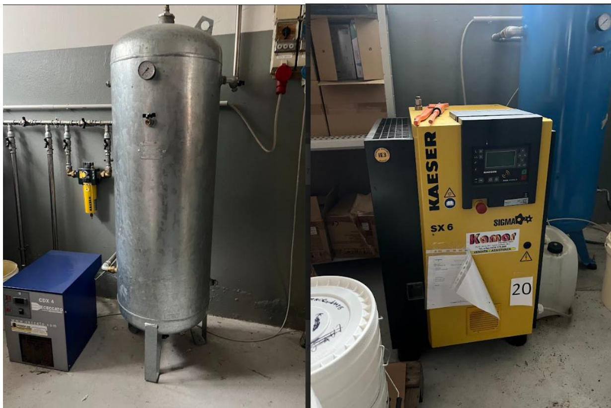
D.3. COMPRESSORE + SERBATOIO + ESSICCATORE
