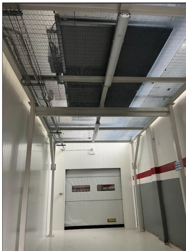
D.47. UNITÀ DI TRATTAMENTO ARIA
