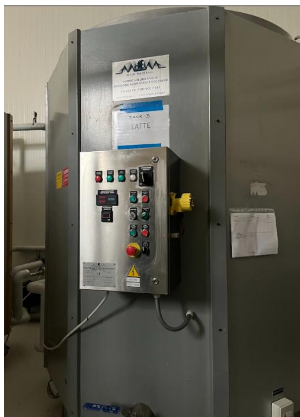
A.2., A.3., A.4. TANK LATTE CON POMPA VOLUMETRICA, FILTRO, MISURATORE DI LIVELLO E TUBAZIONI COLLEGATE
