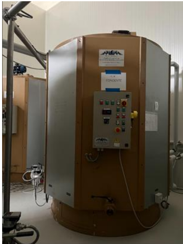
A.5., A.6., A.7. TANK FONDATE CON POMPA VOLUMETRICA, FILTRO, MISURATORE DI LIVELLO E TUBAZIONI COLLEGATE
